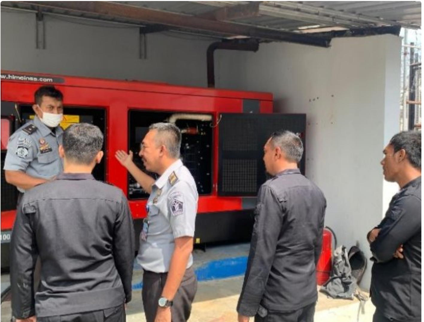
Deteksi Dini Gangguan Kamtib, Lapas Purwokerto beri Simulasi Pengoperasian Genset Kepada Regu Pengamanan
